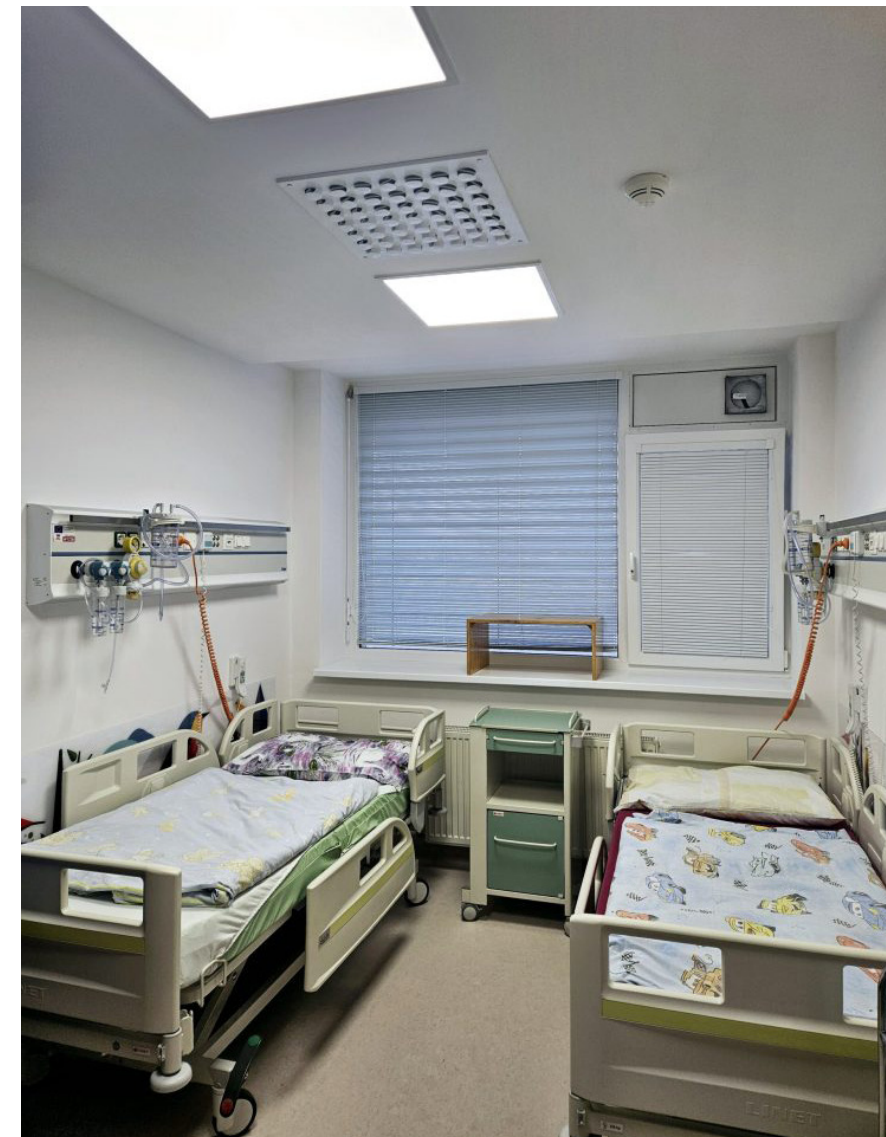
Zrekonštruovaná vzduchotechnika na patientskych izbách
